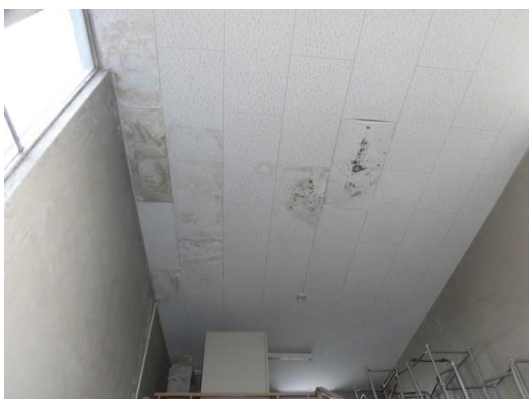
雨漏りによる天井劣化状況
