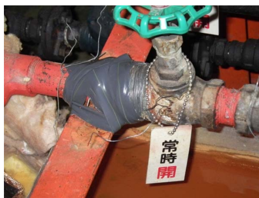
蒸気配管老朽化状況
