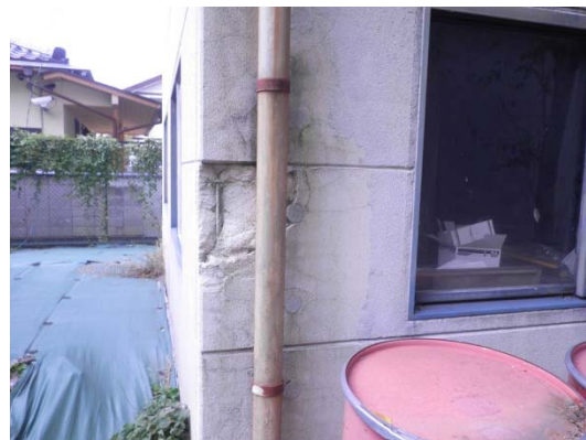
外壁老朽化状況
