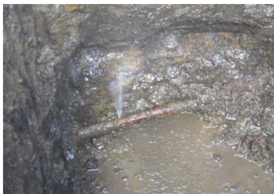
地中埋設給水管漏水状況
